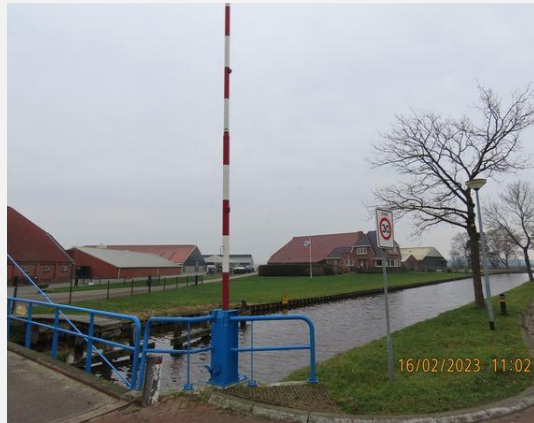
Afsluitboominstallatie - Afsluitboominstallatie, Algemeen (2)
