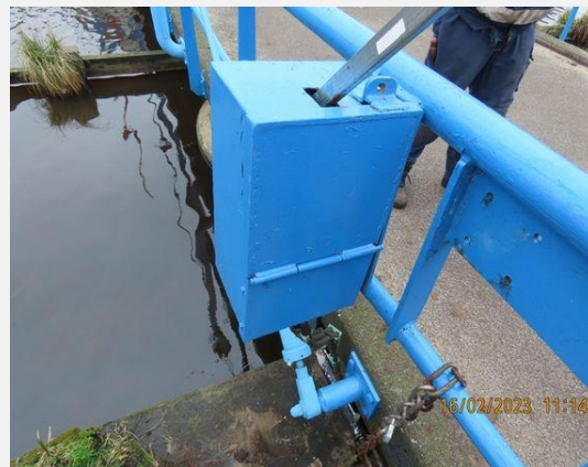
Aandrijving en bewegingswerk (elektrohydraulisch) - Kast (1)
