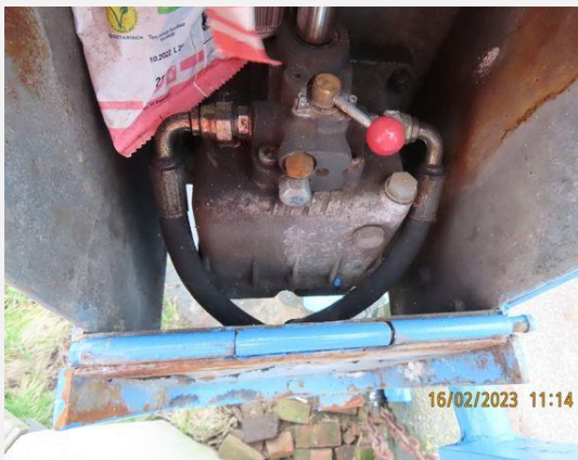
Aandrijving en bewegingswerk (elektrohydraulisch) - Hydraulisch aggregaat (1)
