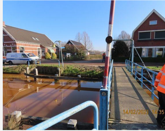
Afsluitboominstallatie - Afsluitboominstallatie, Algemeen (1)
